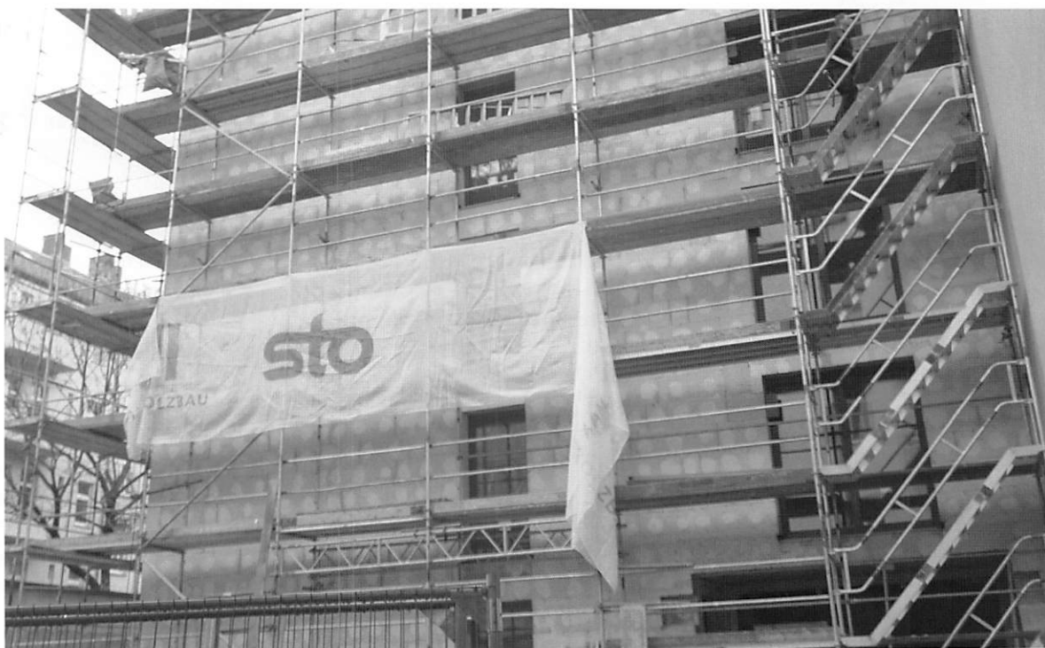
写真1 ベルリン市内でSto社による集合住宅の外断熱改修工事現場視察
